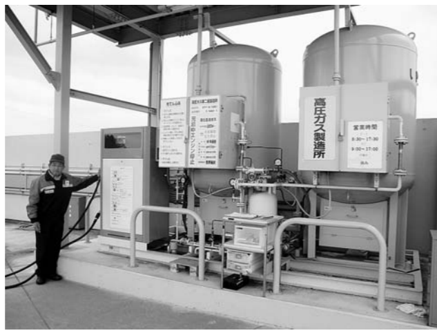
ガソリンスタンドの一角に設置したオートガススタンド。1日30台程度が利用する(総社市の角藤田吉備路SSオートガススタンド)
