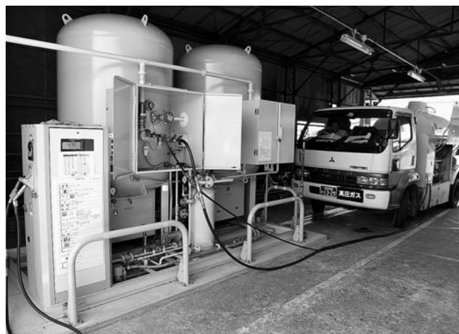
自家用LPGスタンドへ毎日充てんしに来るバルクローリー(久留米市の久留米西鉄タクシー八軒屋営業所)
