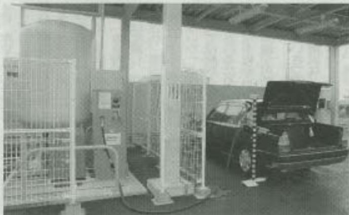
カグラペーパーテック製の自家用LPGガススタンド「オートコンボ」(左)。設置スペースはわずか軽自動車1台分(近江タクシー長浜営業所)
